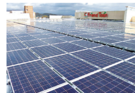
太陽光パネル
